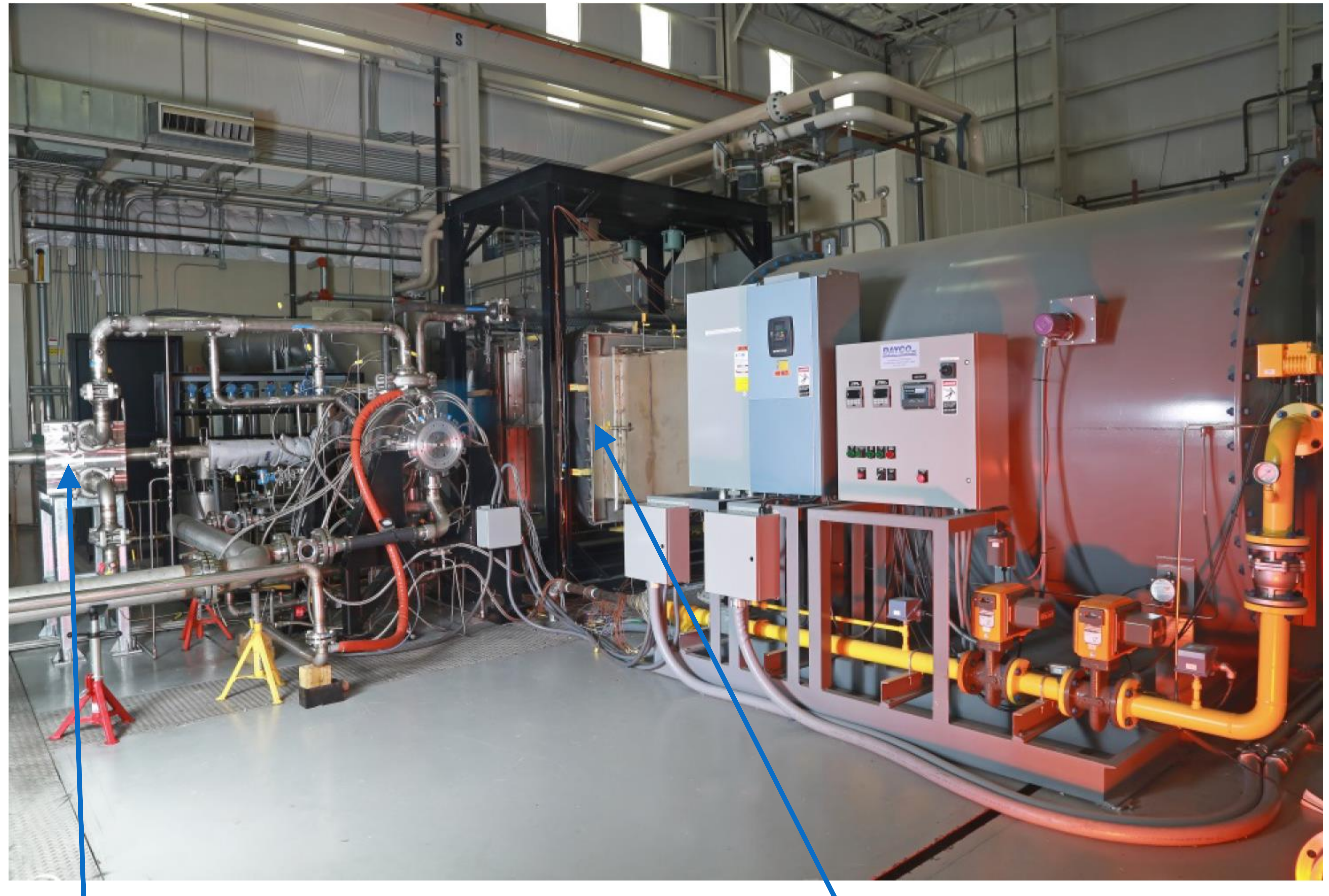
3 MWth recuperator (VPE)
